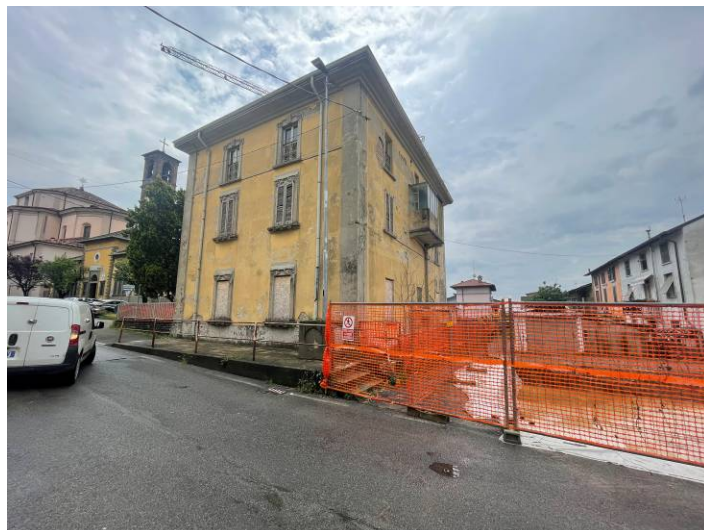
Via Adda – Situazione ante intervento (data 13/06/2023)
