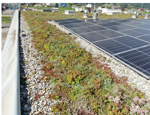
(impianto fotovoltaico su copertura piana con tetto verde)
