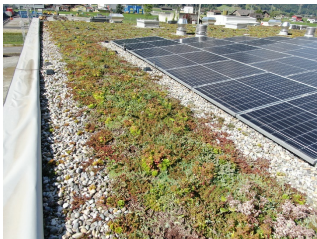
(impianto fotovoltaico su copertura piana con tetto verde)
